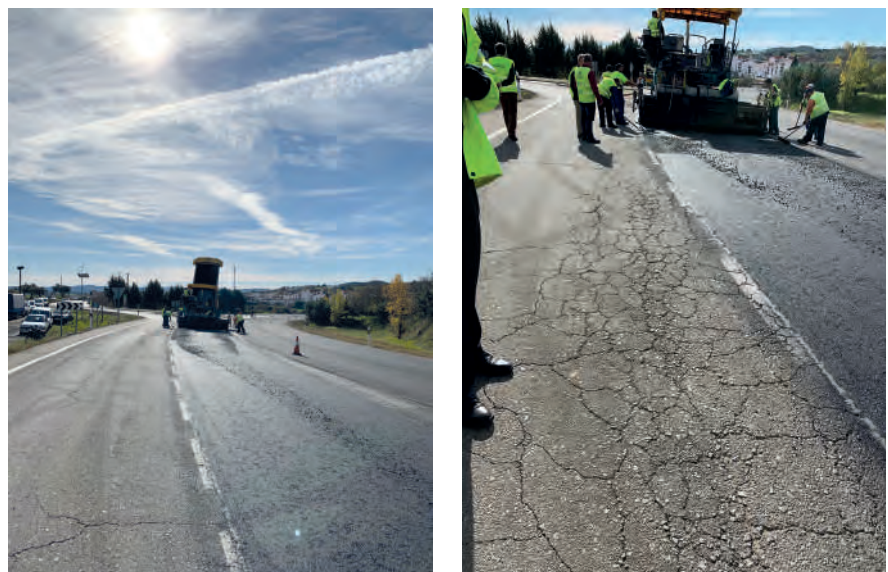
Figura 1. Puesta en obra en la carretera convencional N-435 en Fregenal de la Sierra (Badajoz)
