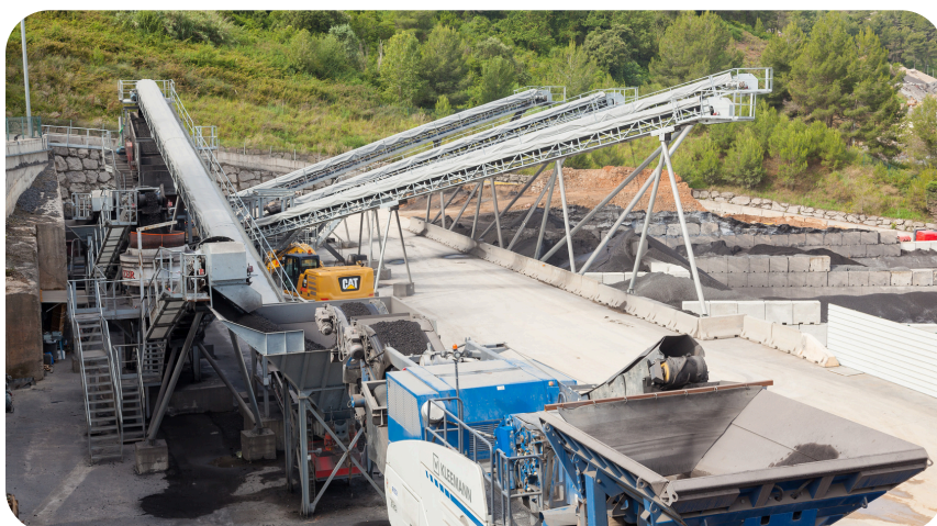
INSTALACIONES DE TRATAMIENTO DE RESIDUOS VALLIRANA
