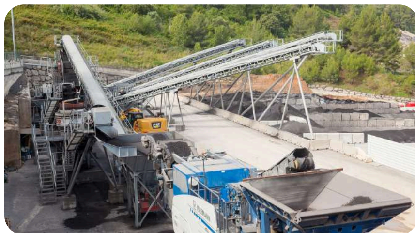
INSTALACIONES DE TRATAMIENTO DE RESIDUOS VALLIRANA
